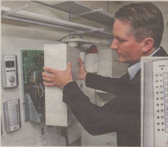
Lutz Neumann öffnet die Abdeckung einer BUS-EMA-Zentrale.
